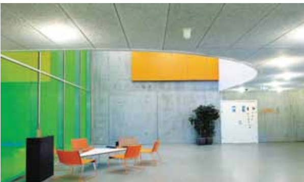
Figura 14. Cielo Raso con juntas visibles entre placas.
