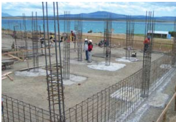
La excavación de la zona de la piscina y el spa. Al lado las fundaciones de los edificios generales.
