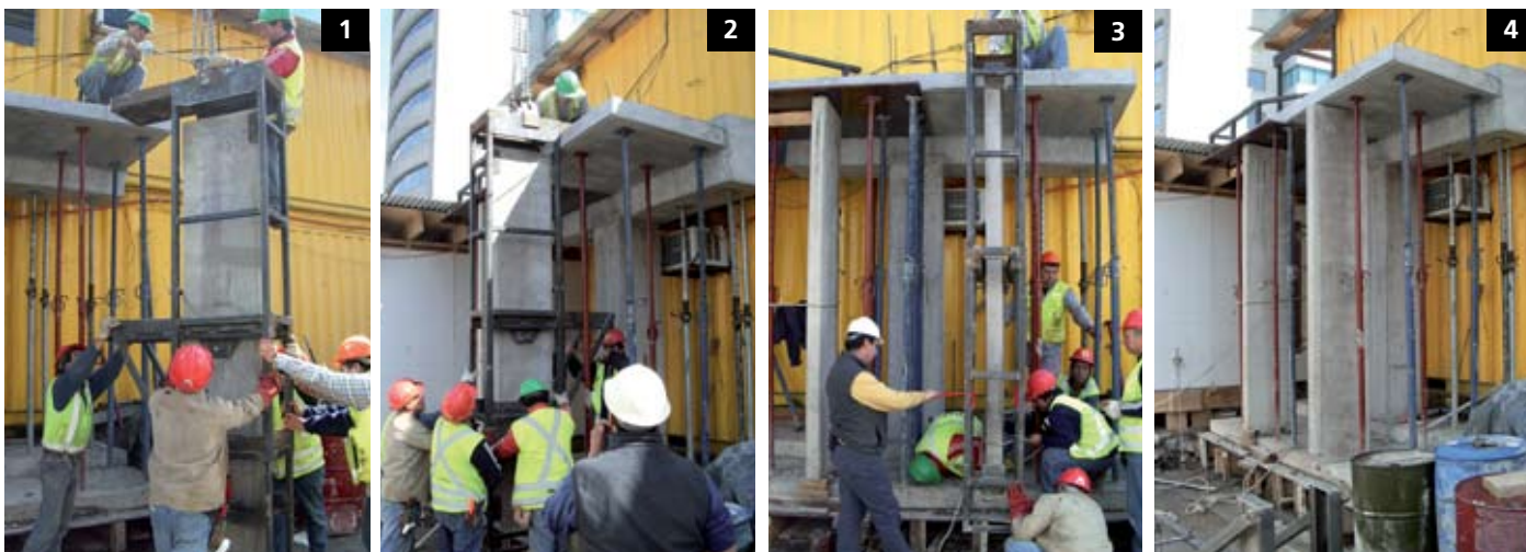
PASO A PASO DE LA COLOCACIÓN DE LOS QUIEBRAVISTAS. 1. Se levantan verticalmente y se introducen en la máquina. 2. Se cuelgan de la losa, quedando a la altura requerida. 3. La celosía se desplaza hacia el interior por medio de los rieles del canastillo. 4. Se termina la faena anclando el quebravista entre piso y cielo.
