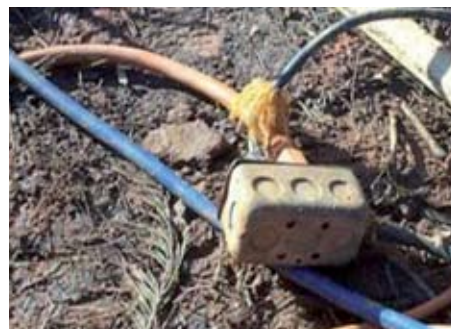
Extensiones dañadas: es una de las causas más frecuentes de accidentabilidad eléctrica.
