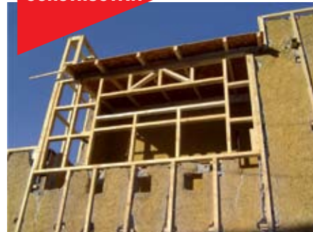
1) Instalación de estructura básica de madera en toda la fachada (adosada exteriormente al muro ya existente). Se puede utilizar también estructura de acero galvanizado.
