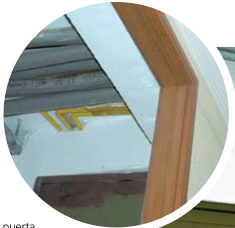
Instalación doméstica de las tuberías de gas en edificio.
