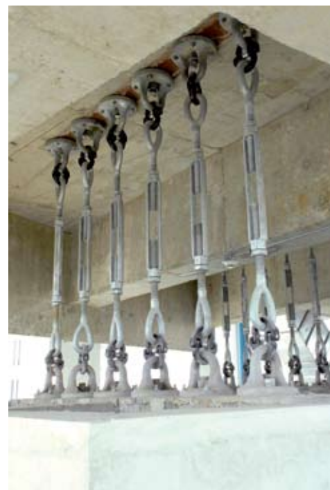
En el edificio Parque Araucano, dos amortiguadores de masa sintonizada, ubicadas en los pisos 21 y el 22, cuelgan de la estructura mediante tensores, cuyos períodos de oscilación se ajustan.
