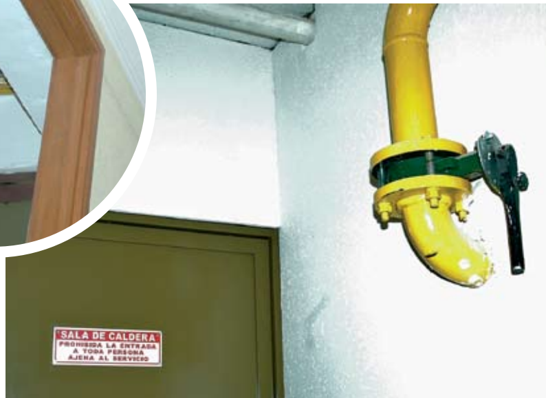
Entrada a sala de caldera con llave de paso.
