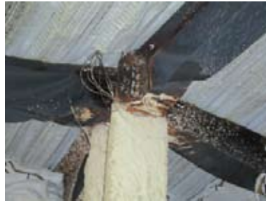
Figura 3: Pandeo local en vigas.
