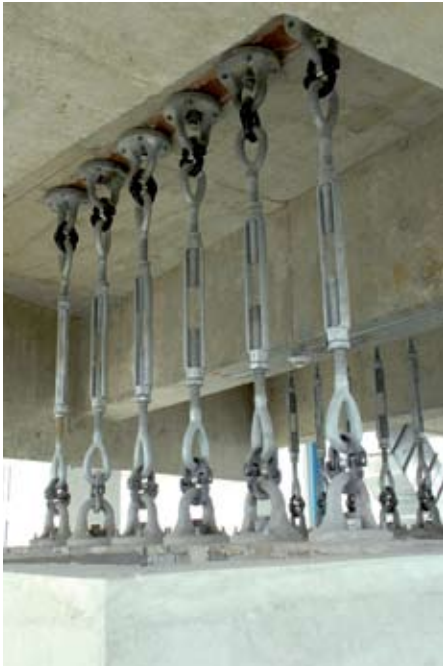
En el edificio Parque Araucano, dos amortiguadores de masa sintonizada, cuelgan de la estructura mediante tensores, cuyos períodos de oscilación se ajustan.
