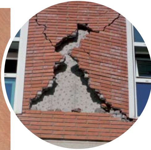
■ Tras el terremoto, los revestimientos de algunos edificios resultaron seriamente dañados, como se aprecia en la imagen.
