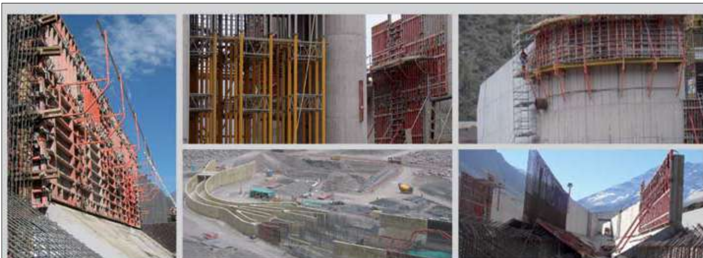
CENTRAL HIDROELÉCTRICA CONFLUENCIA
