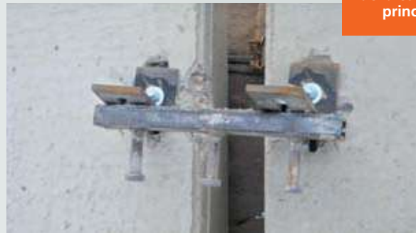
Desprendimiento de los herrajes de la estructura principal.
