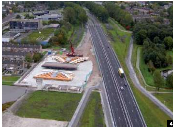
3 y 4. Los puentes fueron hechos en partes y trasladados por tierra al lugar de su asentamiento. En la foto, el Krúsrak, a 1 km de su emplazamiento final, dispuesto a ser armado.
