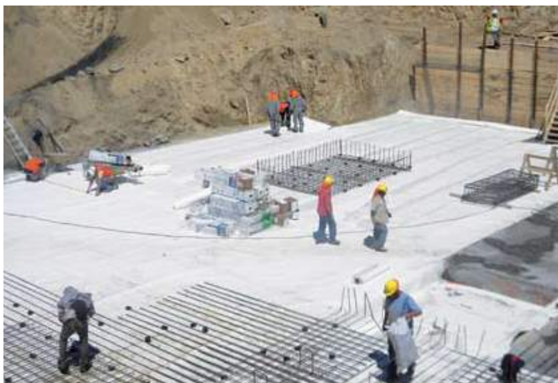
Nov. 2010, obra Vista Villuco, Constructora Socovesa, Instalación de Sistema Preprufe, único en el mundo.
