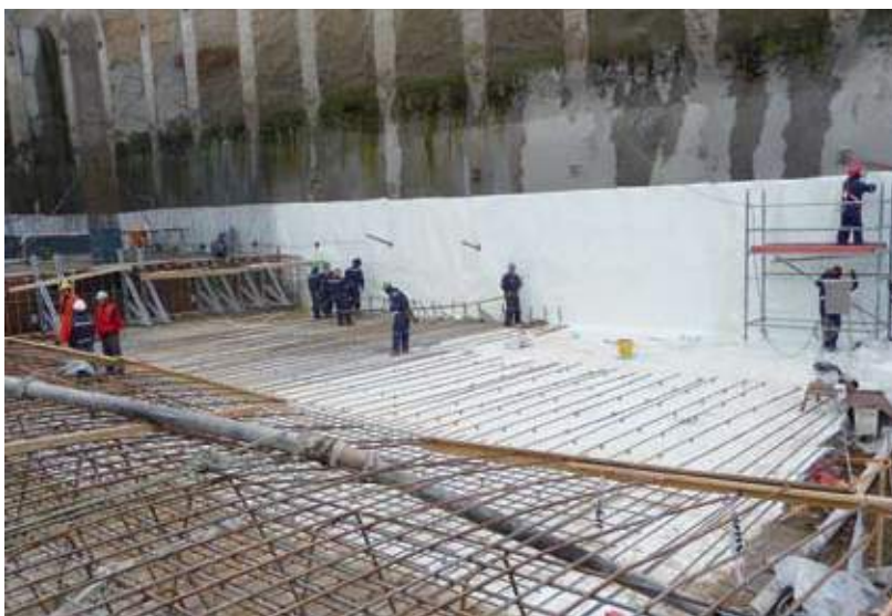
Marzo 2011, Obra Multicentro Talca, Constructora Tecsca. Instalación de Sistema Preprufe, con gran cantidad de agua presente en la obra. Arq. Mauricio Zulueta.
