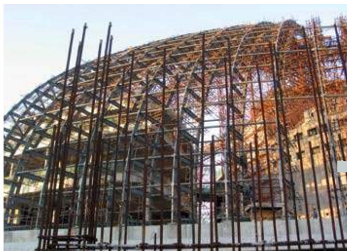
148 vigas de acero tipo Vierendeel forman la cúpula del teatro. Éstas fueron encastradas sobre una base de losa celular de hormigón a 4 m de profundidad.
