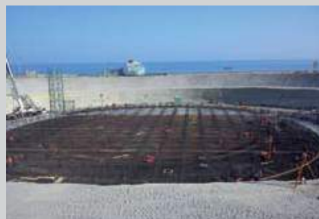
Tanque de Exterior de GNL Norte Grande
