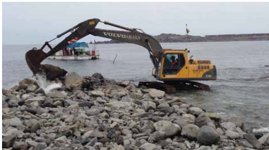
En la costa se ubica el pozo de bombeo que enviara el agua captada a la planta. La preparación de suelo fue fundamental para esta obra.
